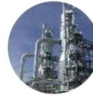
Tecnología de separación térmica
