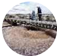
Tratamiento de aguas industriales
