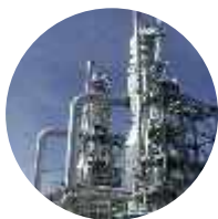
Tecnología de separación térmica
